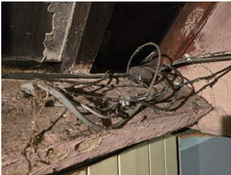
22. 23. 24. Re Wiring required.
